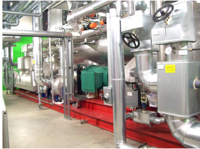
Abbildung 1: Erdgas-betriebene KWK-Module mit ORC-Anlage im BHKW am Standort Stadtwerke Kempen GmbH [1]
