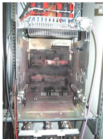
Abbildung 9: Schaltschrank des Leistungsschalters [1]
