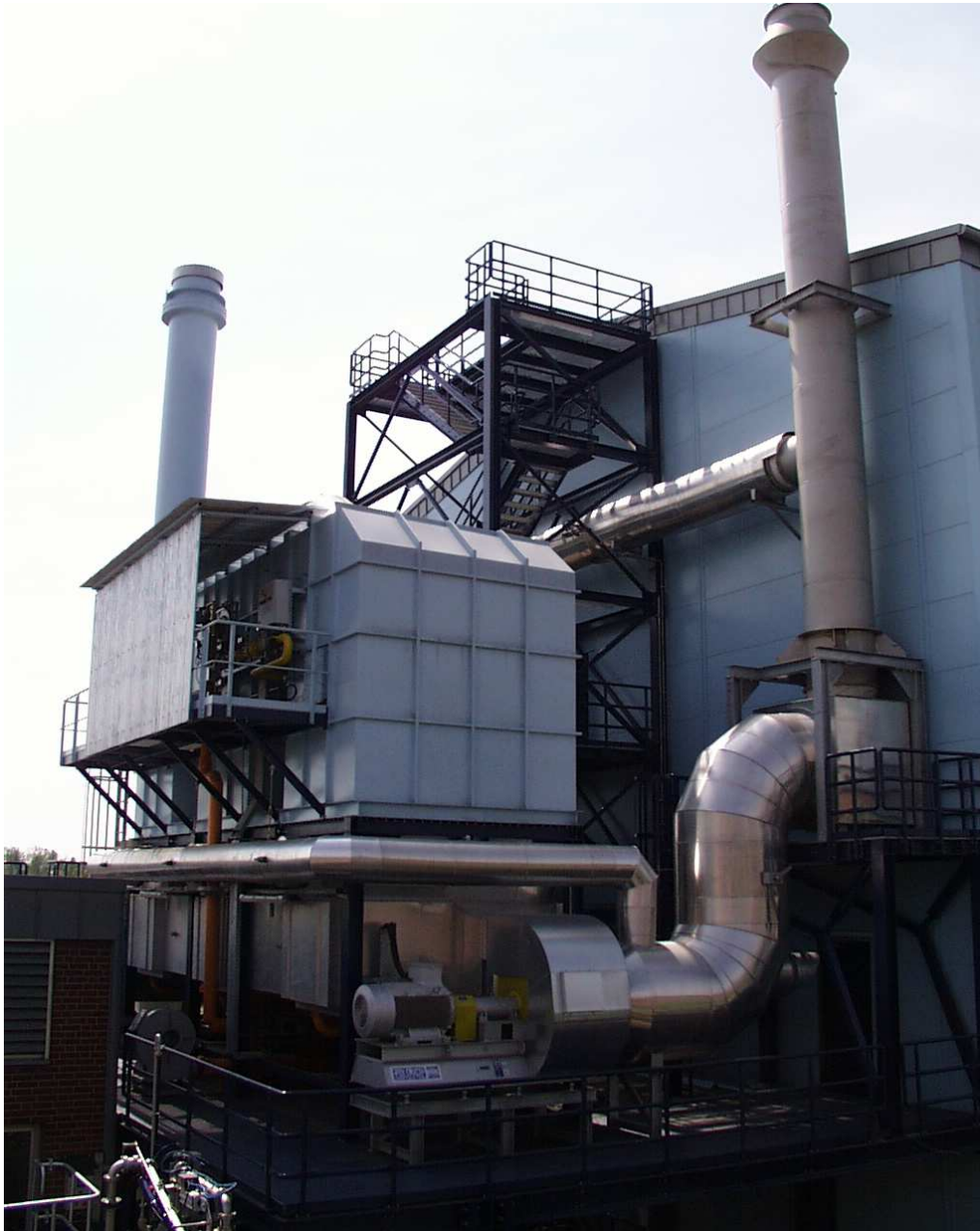
Bild 2 – Ausgeführte Regenerative Abluftreinigungsanlage bei Fa. Rheinzink für 32.000 m 3 /h Quelle: Fa. Rheinzink
