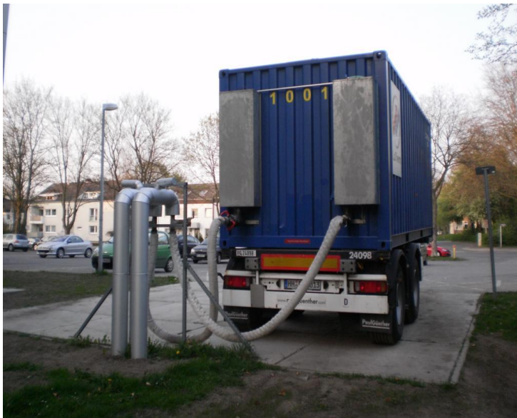
Abb 11 - Container am Hallenbad mit gedämmten Anschlusschläuchen
