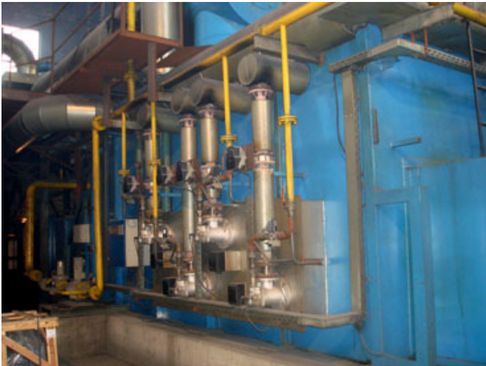
Abbildung 2: Ausbrennofen mit neuen Brennern und Wärmerückgewinnung
