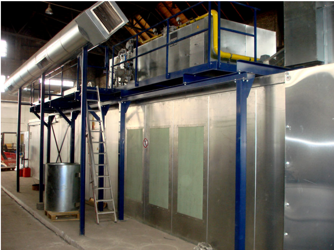
Abbildung 4: Trocknungs- / Trockentunnel mit Möglichkeit zur Hallenbeheizung
