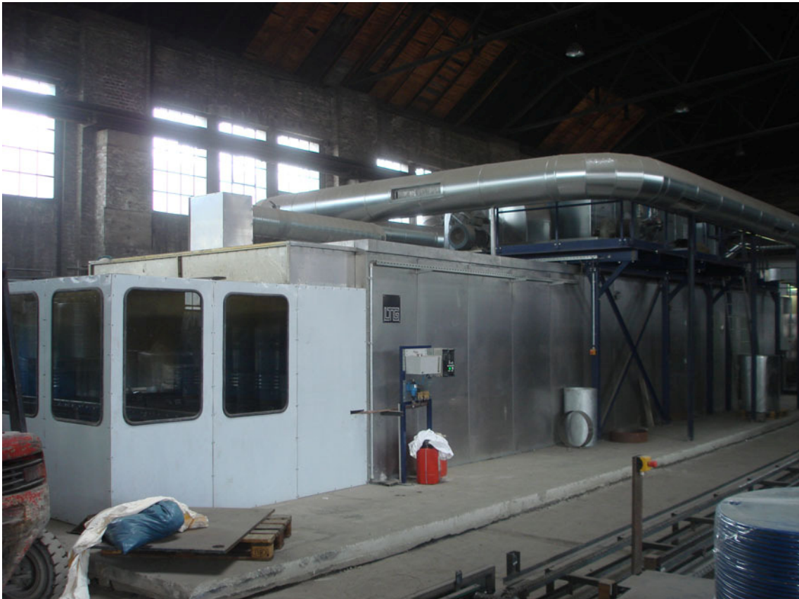
Abbildung 5: Trocknungsoven mit Warmluftzufuhr aus einem Wärmetauscher hinter der TNV
