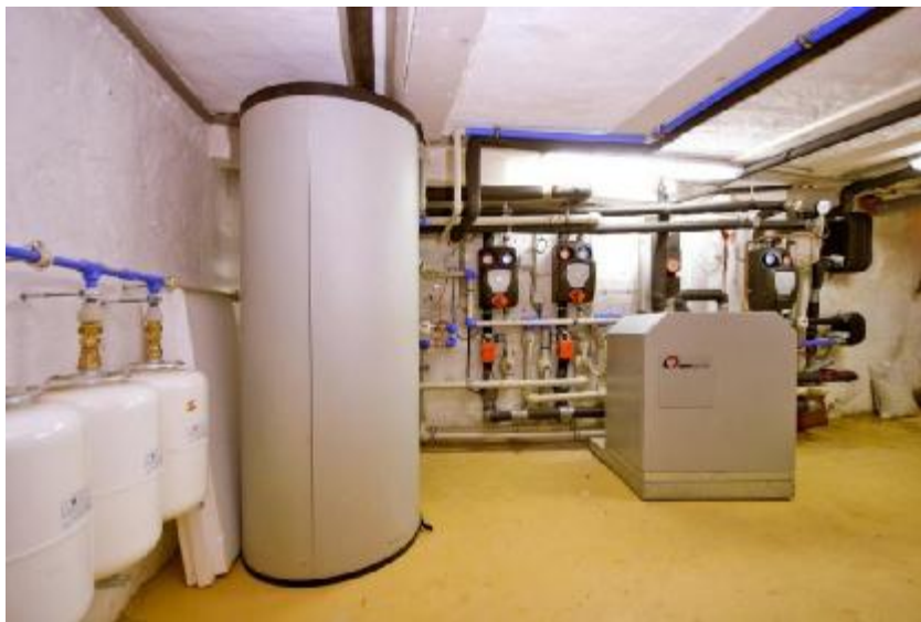
Ansicht Pufferspeicher , Mischer , Wasser-Wasser-Wärmepumpe
