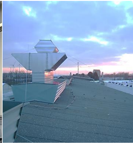
Abbildung 10 Frischluftansaugung und Fortluftauslass auf dem Hallendach
