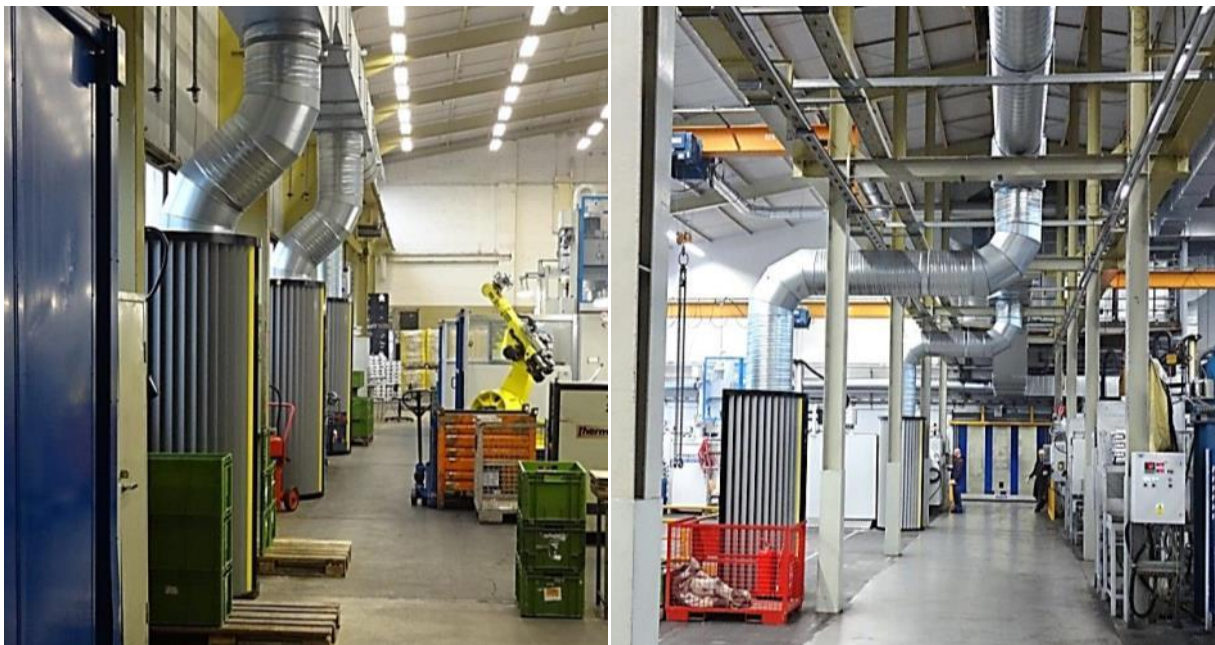
Abbildung 17: Durchgängige Frischlufteinbringung in den Hallenbodenbereich
