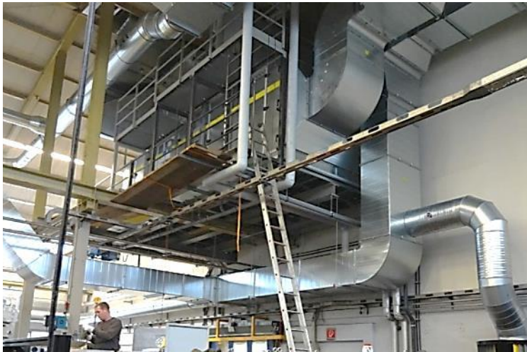
Abbildung 9 Aufbau der Luftaufbereitungszentrale im Halleninneren
