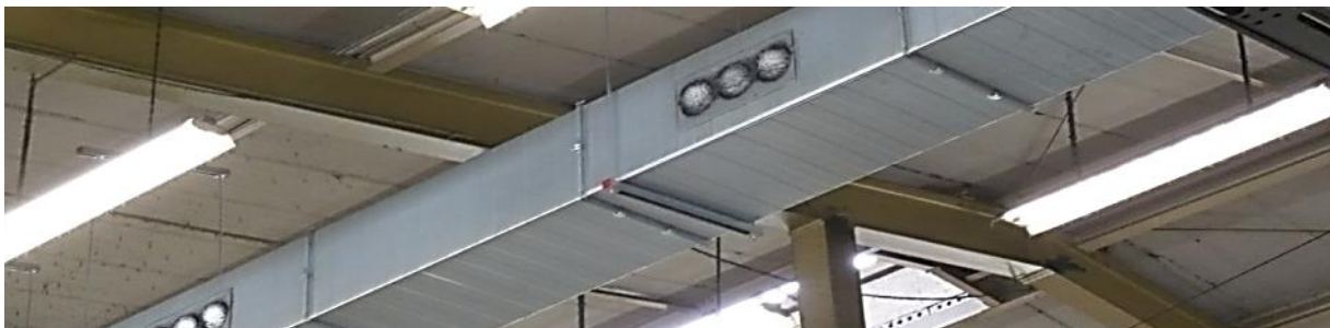
Abbildung 8 Abluftkanal unter dem Hallendach
