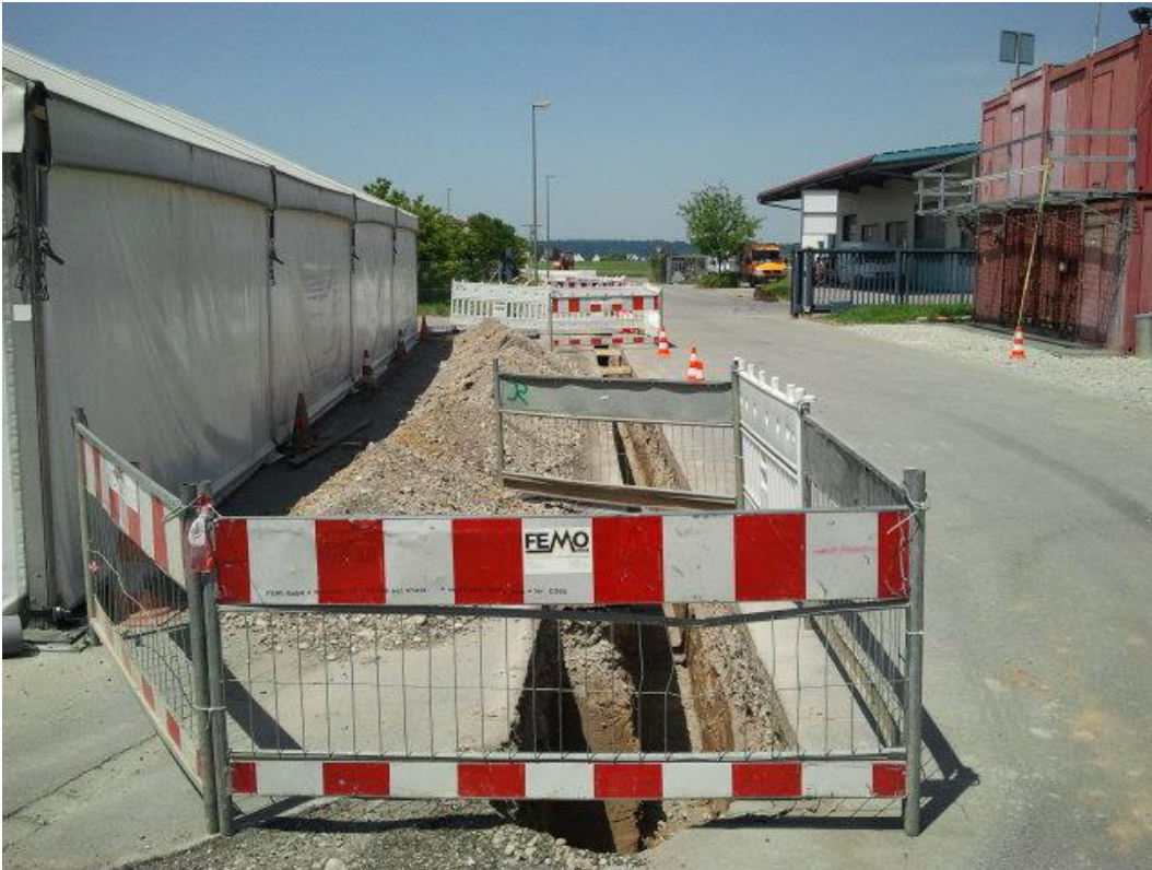
Abbildung 2-4 Erdgas-Hochdrucktrasse (Aufnahme Juni 2013)
