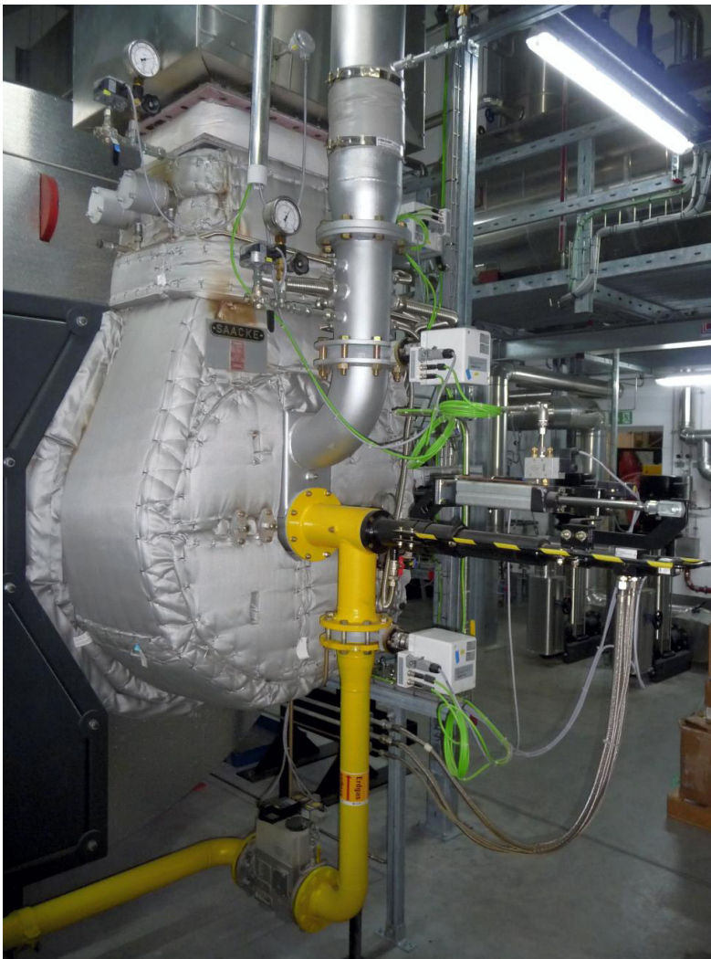
Abbildung 3-12 Gasturbinen-Abgasbrenner mit „Matratzenisolierung“
