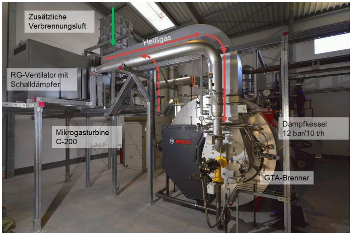
Abbildung 3-11 Kesselhaus Interquell Großaitingen mit MGT und GTA-Brenner
