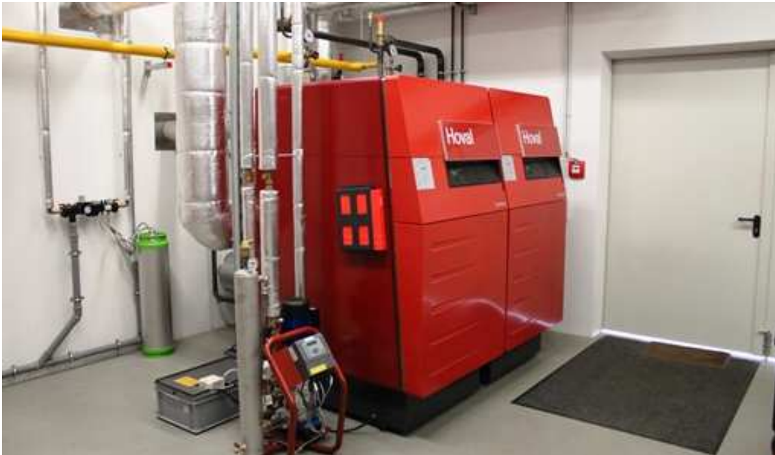
Abbildung 7: redundanter Gaskessel und automatische Druckerhöhung
