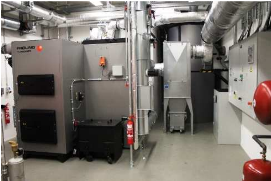
Abbildung 6: Hackgutkessel mit Pufferspeicher und Zyklon-Abscheider
