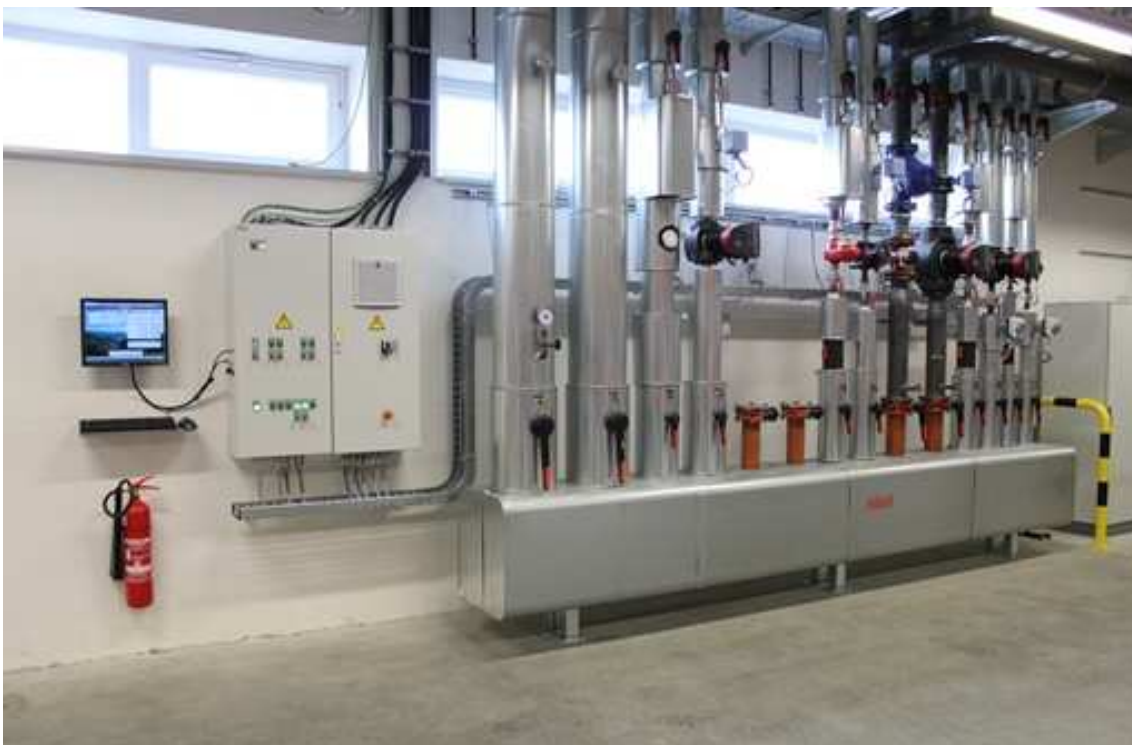
Abbildung 8: Heißwasserverteiler mit Schaltschrank und Gebäudeleitrechner (GLT)
