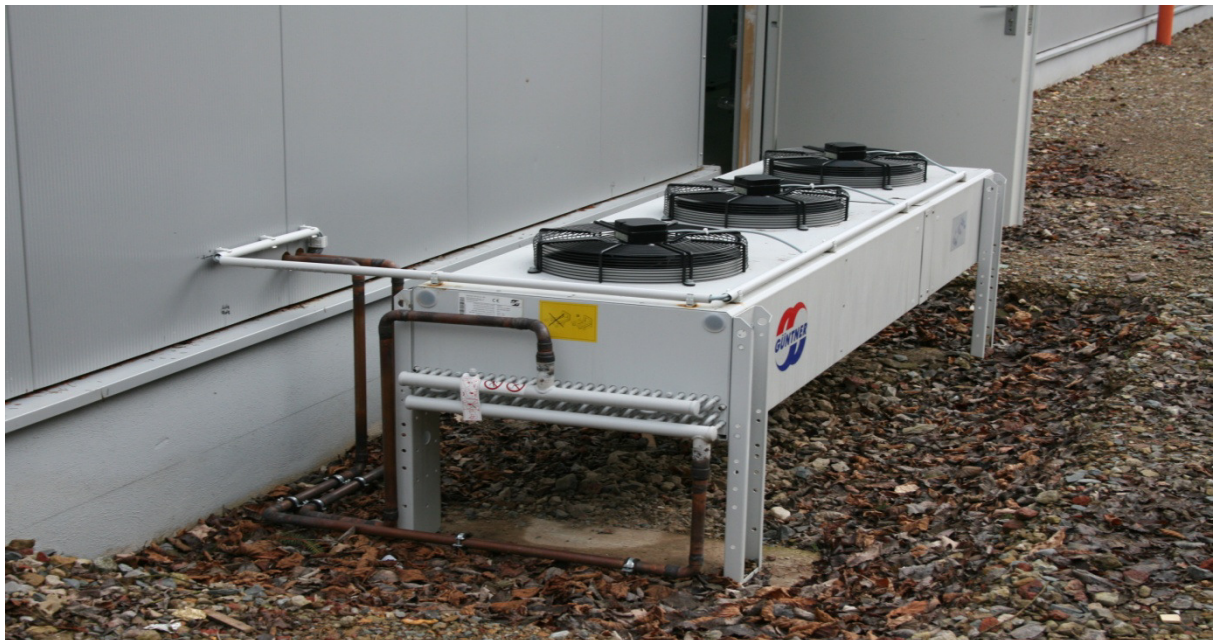
Abbildung 8: Separater Verflüssiger in Leiseläuferausführung (Foto aus September 2013)
