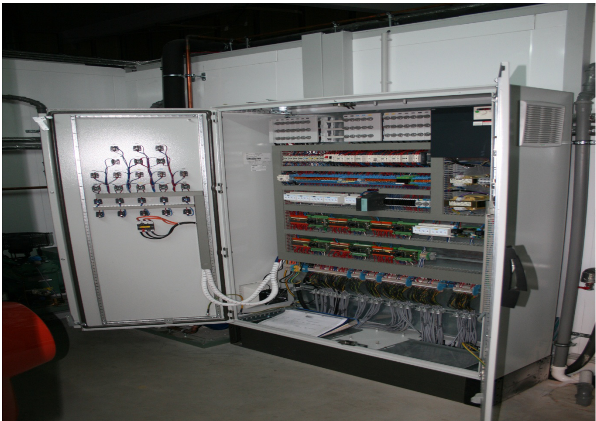
Abbildung 6: Foto des geöffneten Schaltschranks (Foto aus September 2013)
