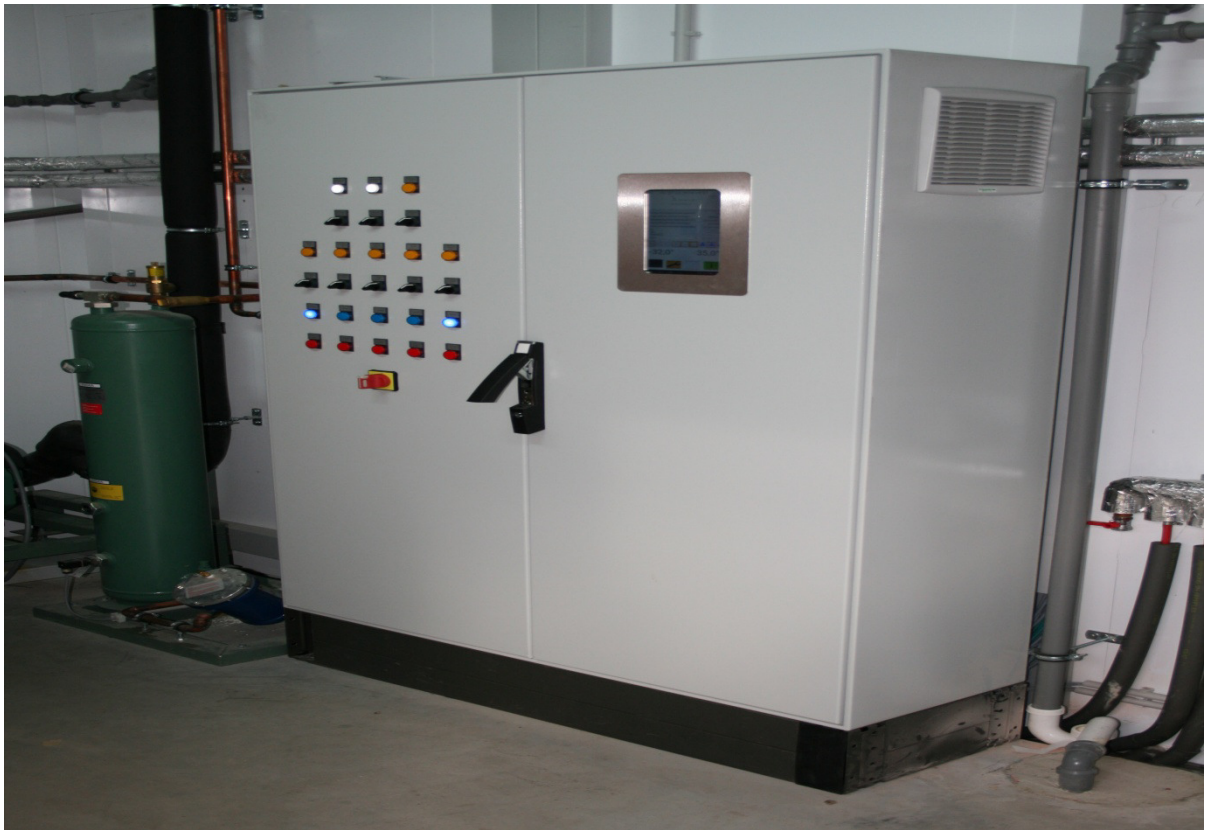
Abbildung 5: Foto des geschlossenen Schaltschranks (Foto aus September 2013)
