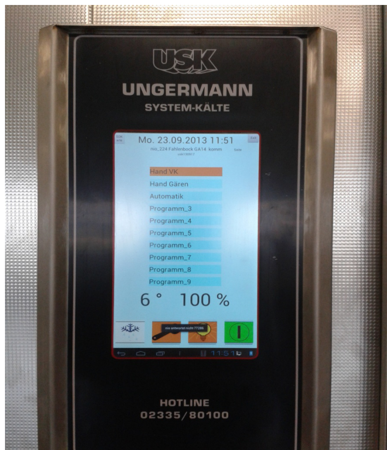
Abbildung 14: Frontansicht auf die Cooltab Steuerung (Foto aus September 2013)
