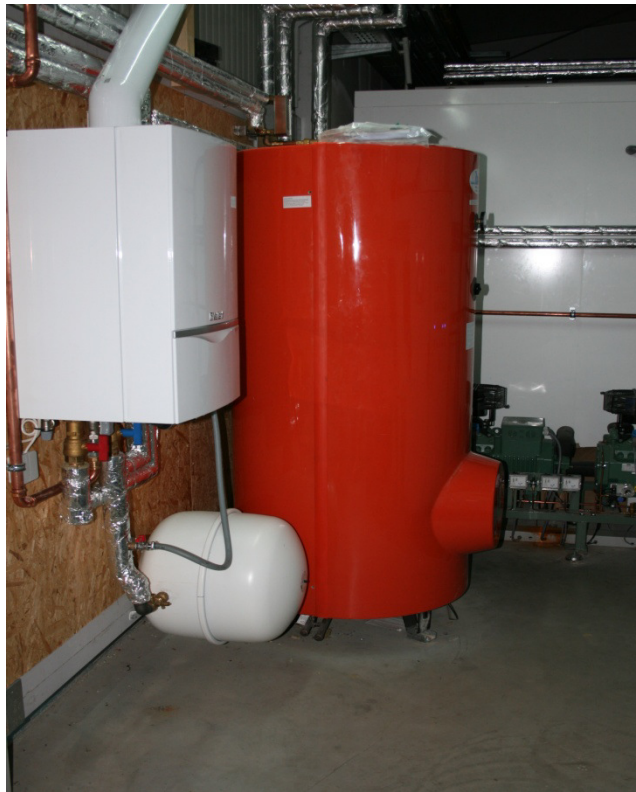
Abbildung 7: Foto der Wärmerückgewinnungskomponenten (Foto aus September 2013)
