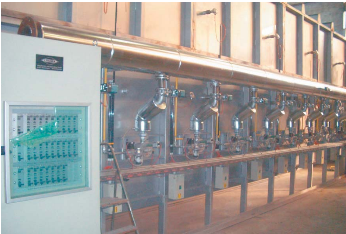
Abbildung 11: Blick von Aussen auf die Impulsbrenner mit Schalttafel zur Steuerung bzw. Regelung der Brenner
