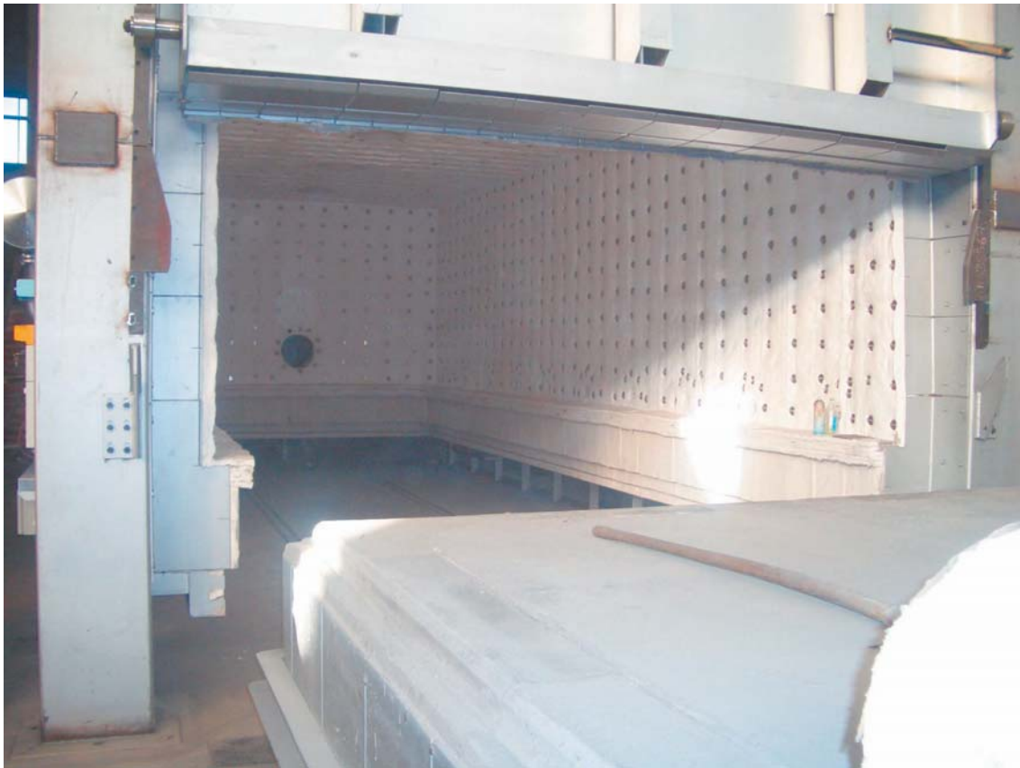
Abbildung 2: Blick auf die keramische Faserauskleidung des Ofenraums und die Abdichtung Herdwagen-Ofen
