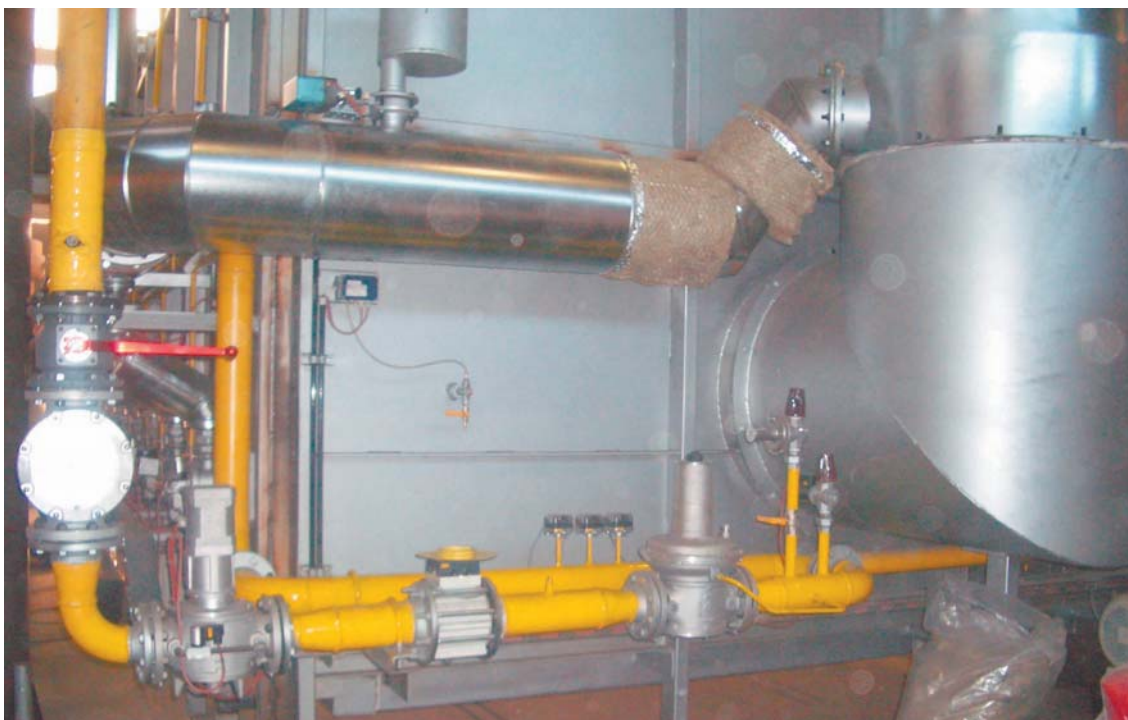
Abbildung 12: Blick auf die Abgasausschleusung mit Verbrennungsluftvorwärmung zur Wärmerückgewinnung aus den Ofenabgasen
