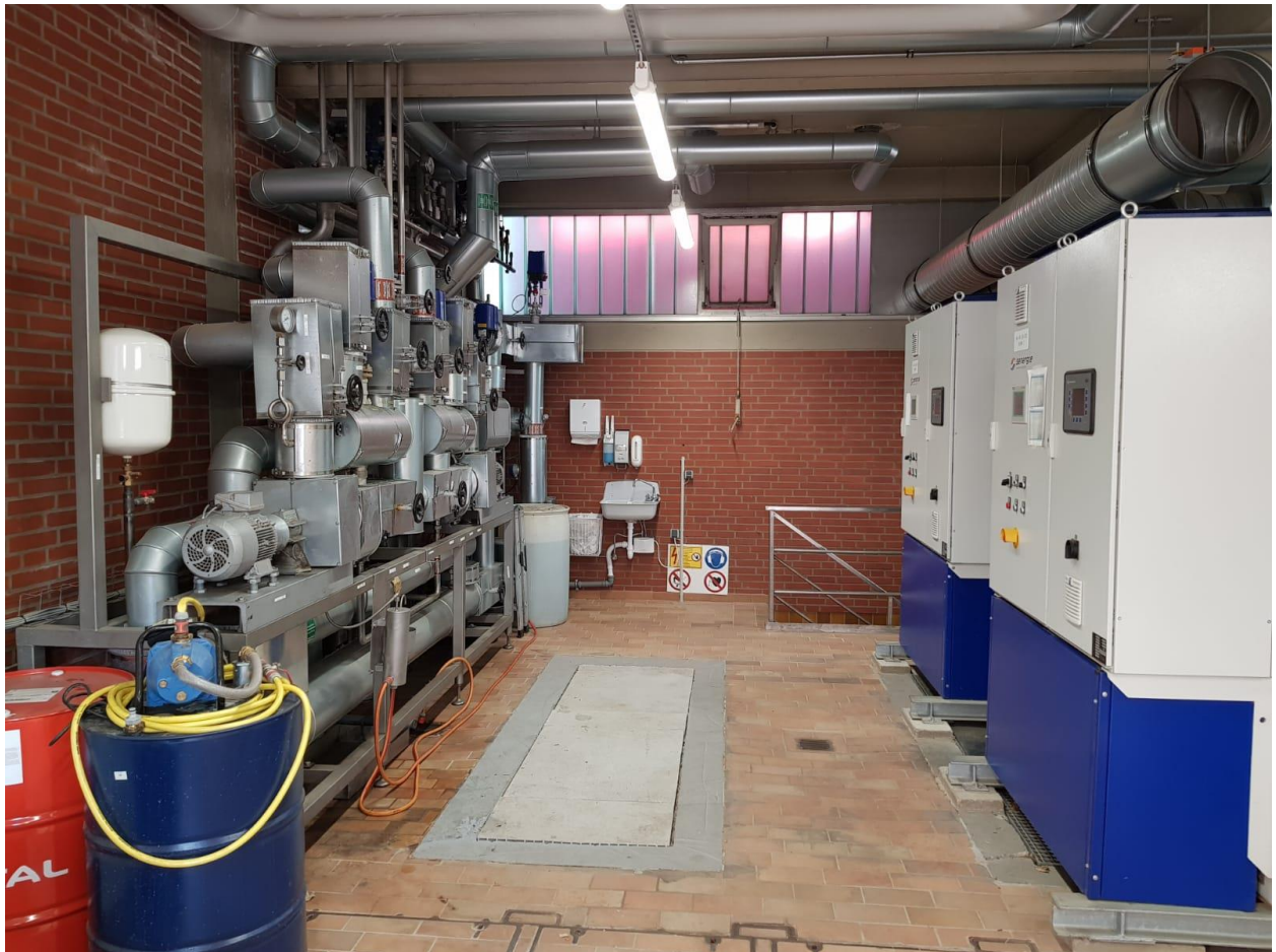
Abbildung 29: BHKWs (rechts) mit Thermalöl-System (links)
