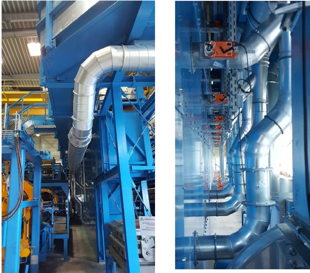
Abbildung 30: Anbindung des Hochregallagers an die Entstaubungsanlage
