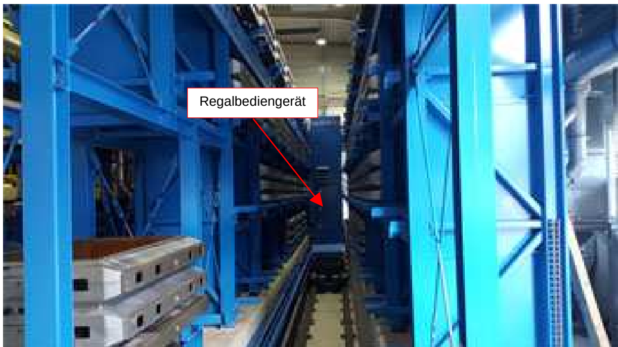
Abbildung 14: Blick in Richtung des Regalbediengerätes des Hochregallagers
