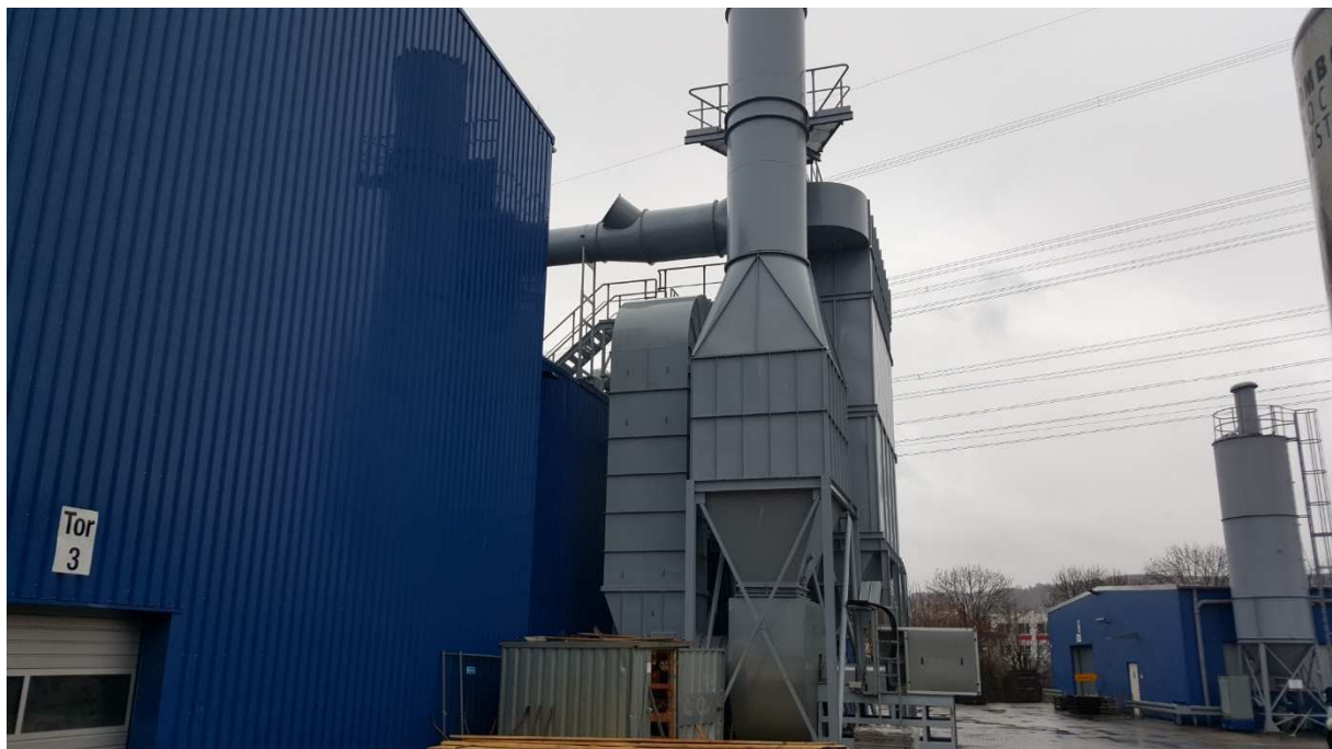
Abbildung 26: Parallel zum Vorhaben installierte zentrale Luftversorgungsanlage | 02.02.2016
