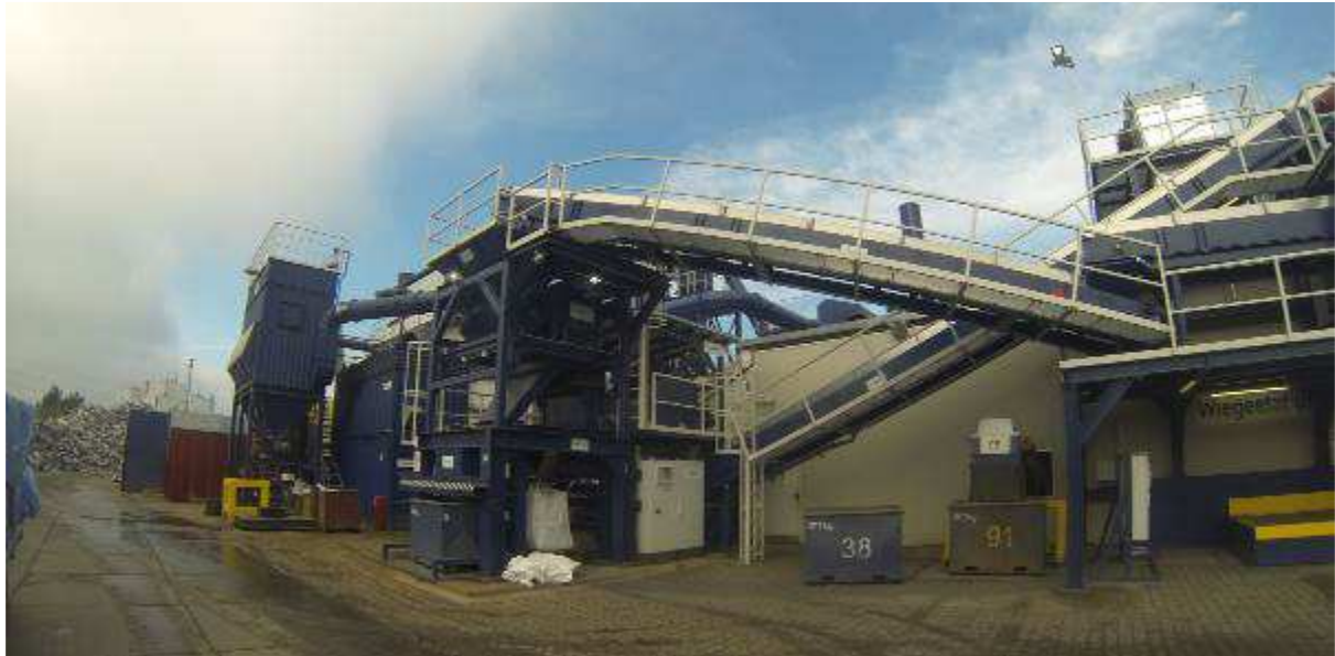
Abbildung 3: Blick auf die Siebanlage
