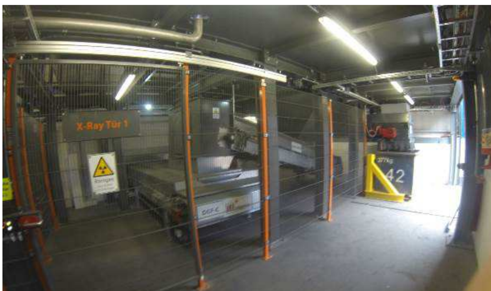
Abbildung 5: Blick auf die Abschirmung der Röntgensortieranlage
