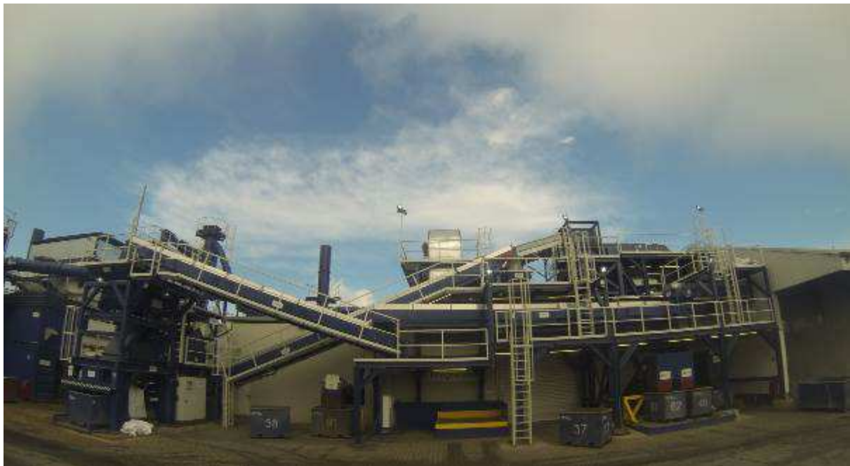
Abbildung 2: Fördersektion der Schredderanlage
