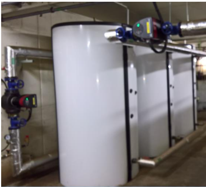
Bild 12: Die neuen Kessel der Brauchwasserversorgung
