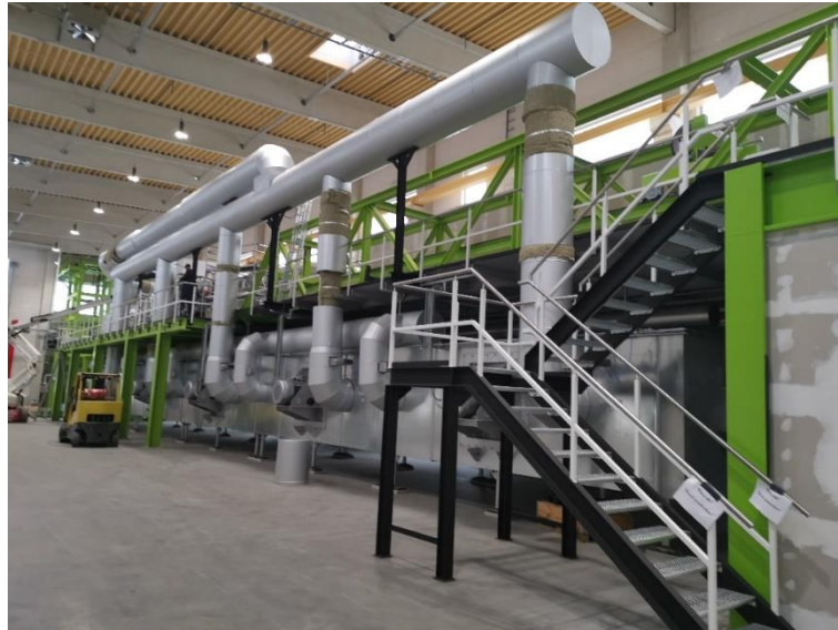
Abbildung 17: Trockner mit Zu- und Ablaufrohren
