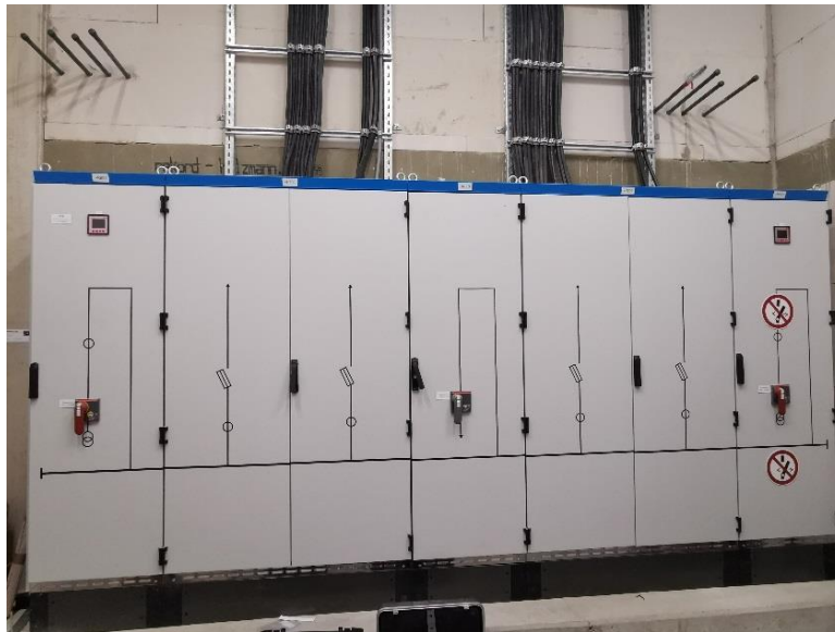
Abbildung 13: Teilansicht der Elektronikausrüstung
