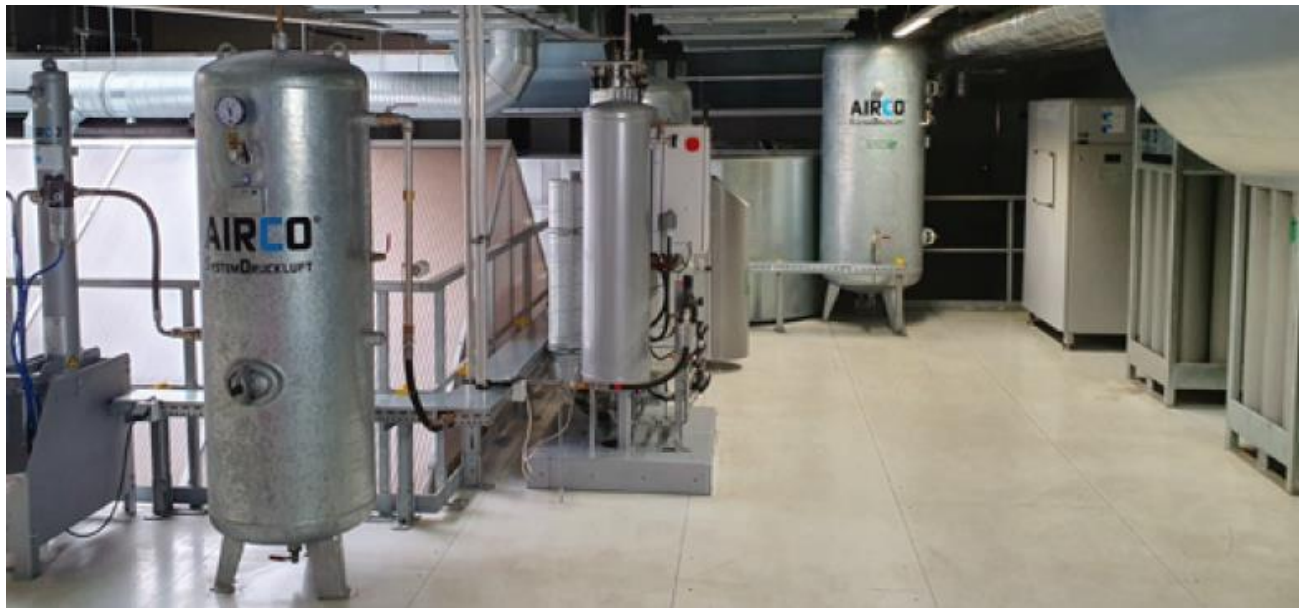
Abbildung 18: Luftzerlegungsanlage zur Herstellung von Schneidgasen
