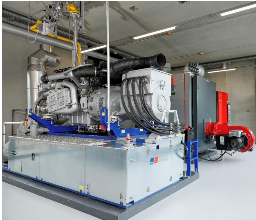
Abbildung 14: Das Blockheizkraftwerk in der Energiezentrale der Müller Produktions GmbH
