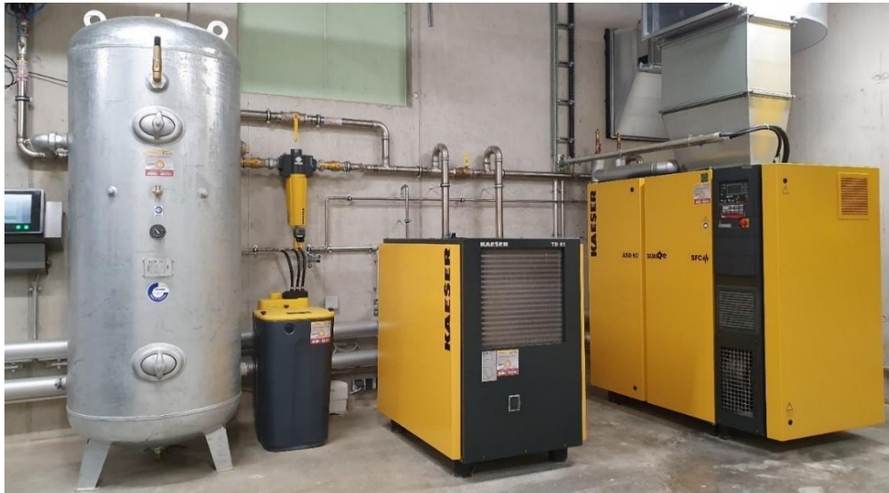
Abbildung 19: Druckluftanlage in der Energiezentrale
