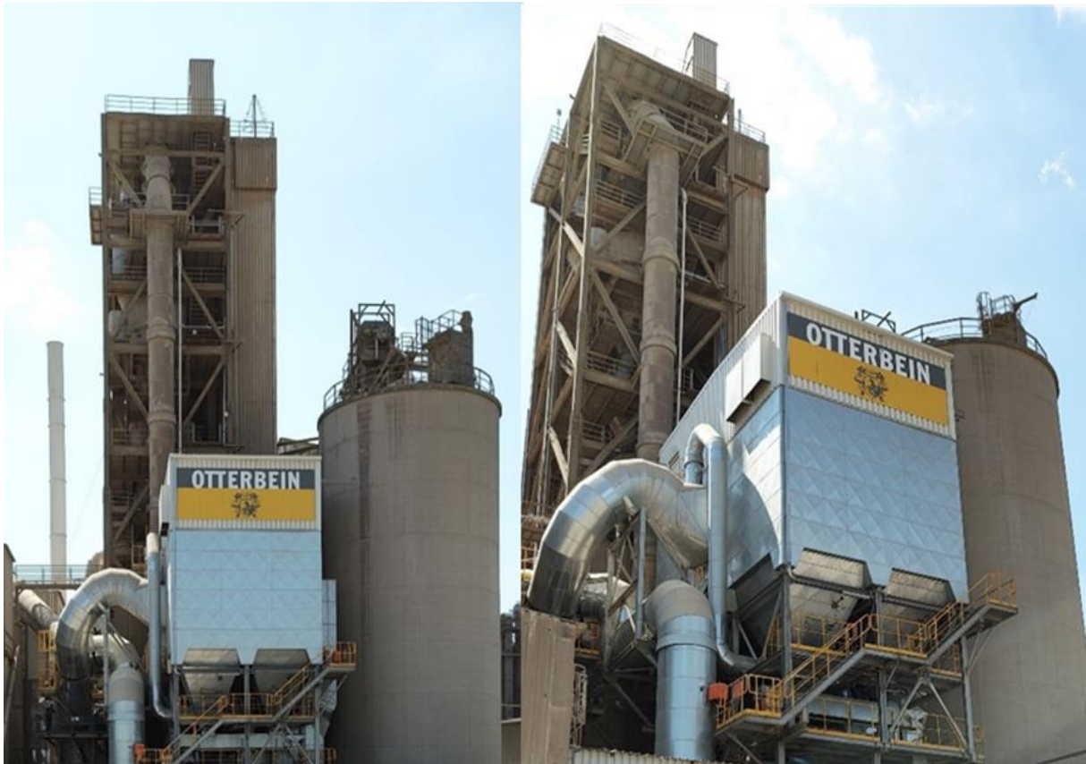
Bild 2-4 Werksansicht der HGF-SCR-Anlage vor dem bestehenden Wärmetauscharturm
