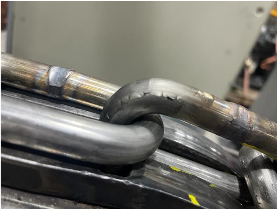
Abbildung 26: Wieder Materialaufplatzer bei hochfesten Drähten (Foto aus 2024)
