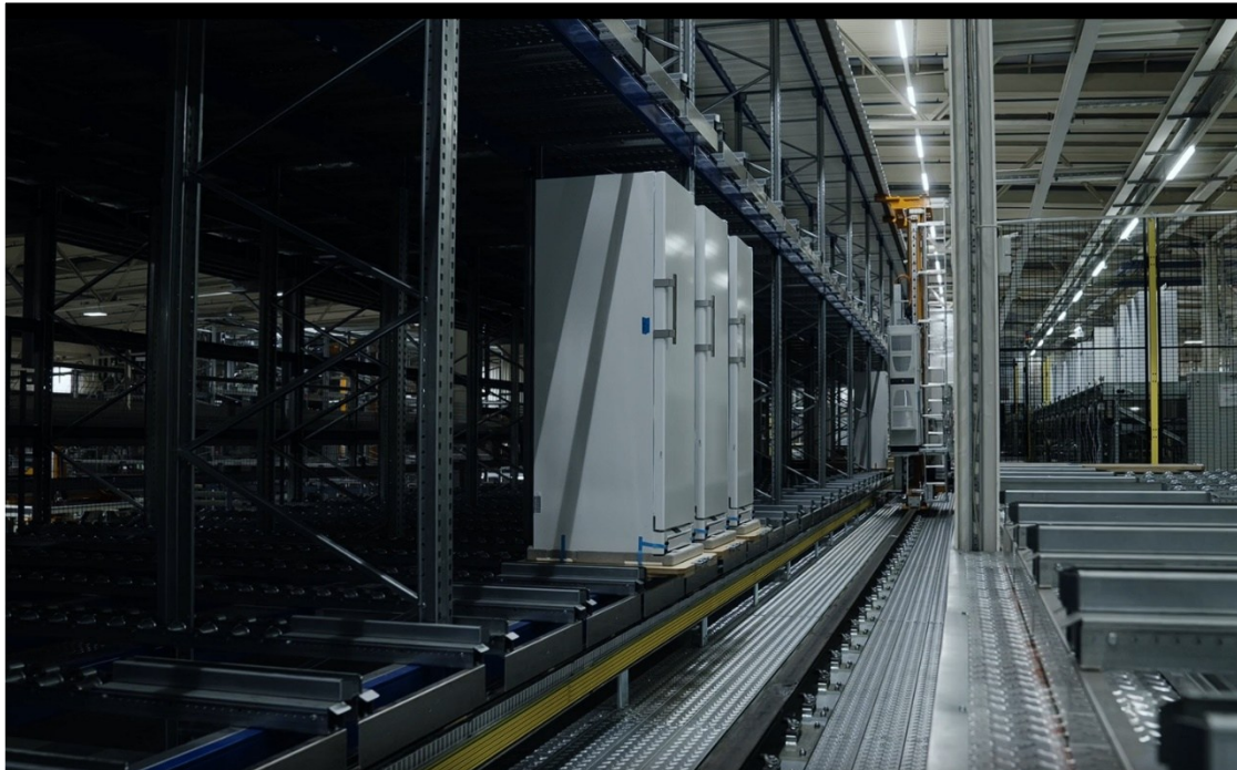
Abbildung 16: BluRoX-Geräte in der automatischen Druckausgleichsanlage
