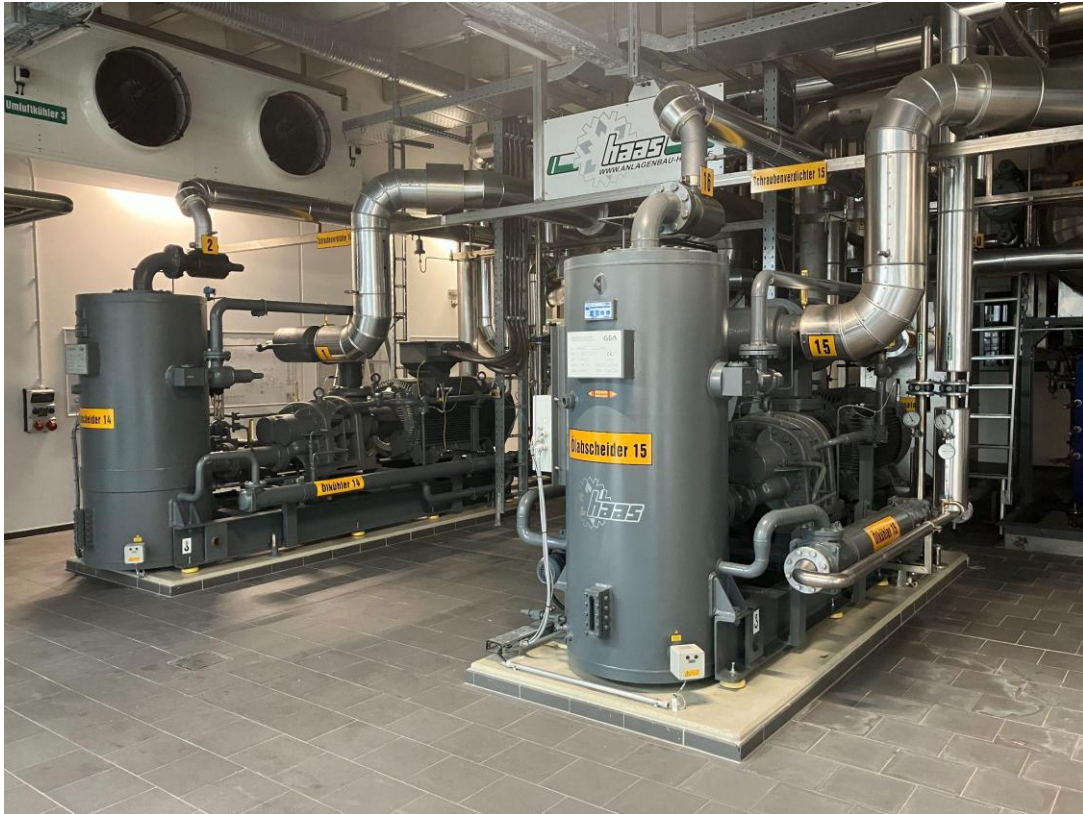
Abbildung 8 Eiswassererzeuger 14 & 15 mit Wärmeauskopplung 30 °C zu 45 °C
