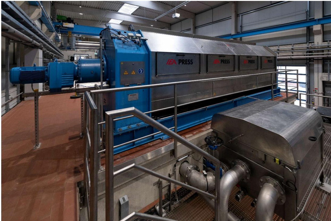
Abbildung 3: Schlammvorentwässerung und Filtratnachbehandlung (Trommelfilter)
