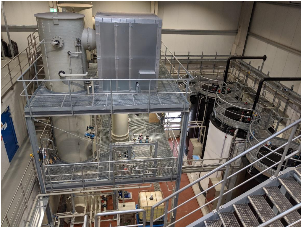
Abbildung 10: Luftstrippung (Fa. RVT PE) und Chemikalienlager
